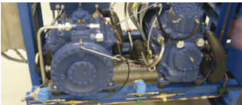
De CO 2 -installatie in het trainingscentrum.
