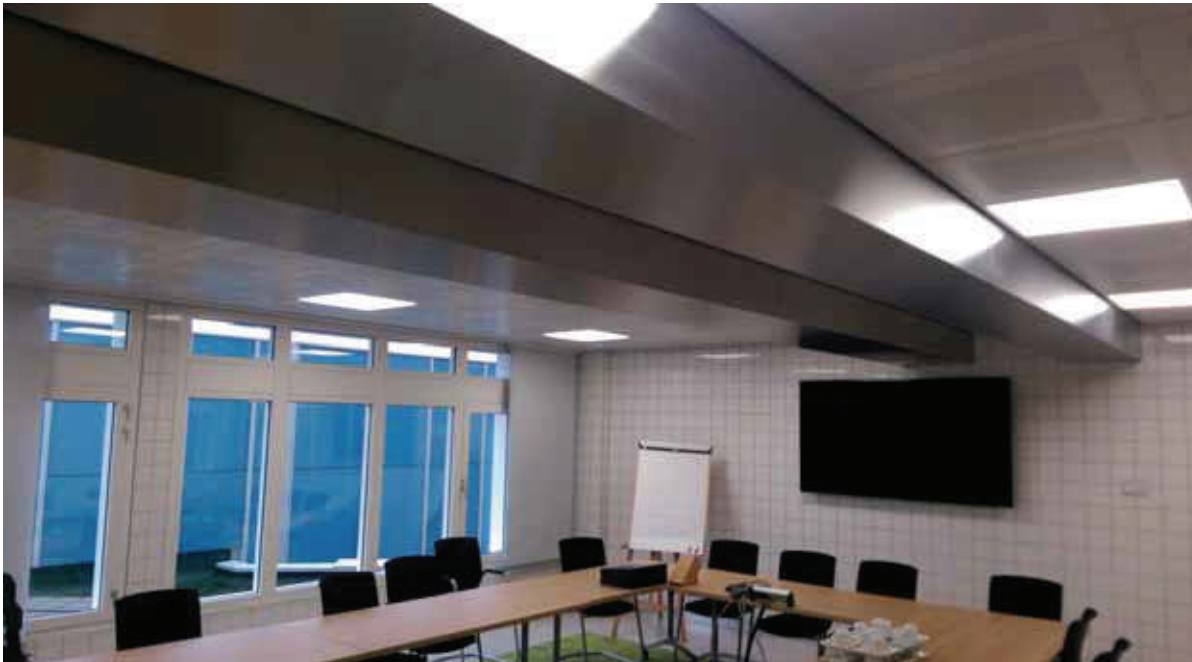
Het klimaatplafond van het ABN Amro-kantoor in Amsterdam. De ventilatielucht (groene kanalen) wordt boven het systeemplafond uitgeblazen.
